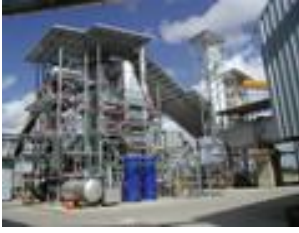
De combustible sólido con el lijado de combustión de polvo, potencia de 24 MW, Tailandia
